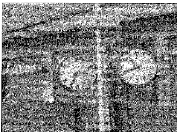
Zdjęcie nr 23. Niespójne wskazania zegarów zainstalowanych na zewnątrz budynku dworca
