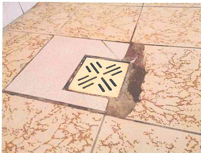
3. Stan odpływu z części pisuarowej - wadliwa konstrukcja, stojąca woda.
