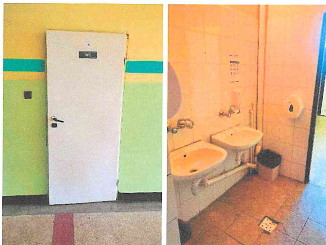
1. Drzwi do toalety oraz przedsionek z umywalkami i zapadniętym odpływem.
