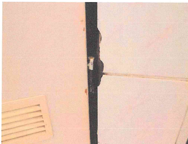
6. Ubytki w płytkach.
