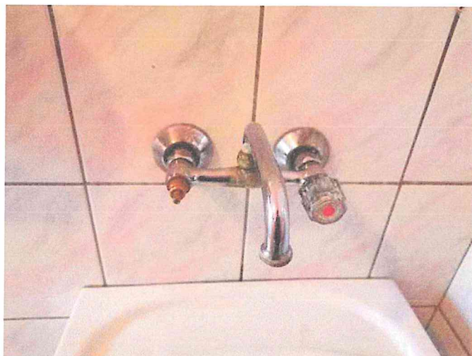
6. Brak kurka w armaturze łazienkowej.
